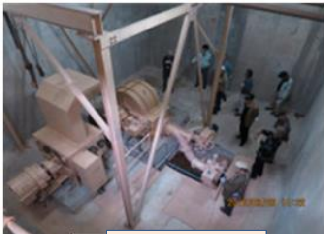
小又川発電所発電施設
